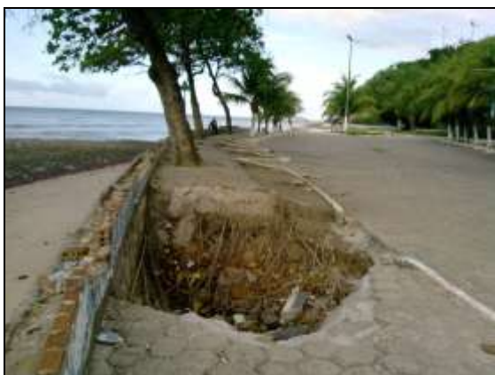
FIGURA 06: Dano decorrente da erosão na Praça de Iemanjá. Fonte: SEMAM.
